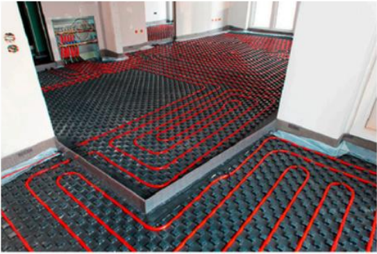
Calefacción por suelo - radiante: 2 cajas colectoras (1 por planta) - A través de tuberías de agua caliente
